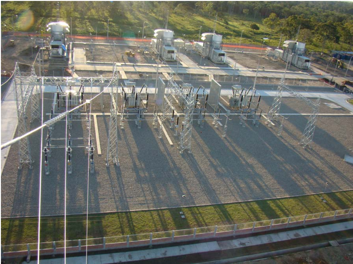
Foto: Los cuatro Turbogeneradores Siemens SGT-700 y la subestación instalados en la Planta Termoeléctrica Entre Ríos
