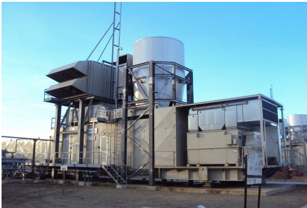
Foto: Turbogenerador Siemens SGT-700
