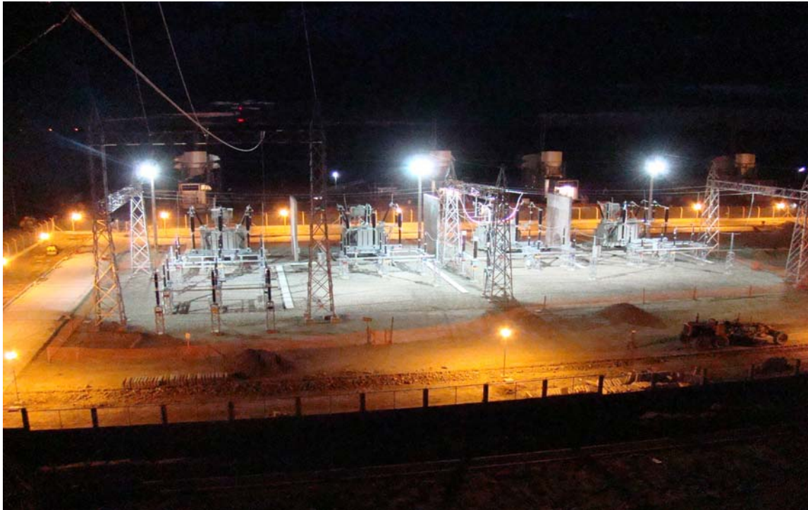
Foto: Sub Estación Planta Termoeléctrica Entre Ríos
