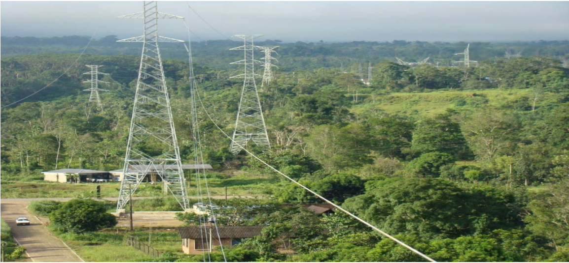
Foto: Vista General de la línea de transmisión en 230 KV que interconecta la Planta Termoeléctrica de Entre Ríos con la Subestación de Carrasco
