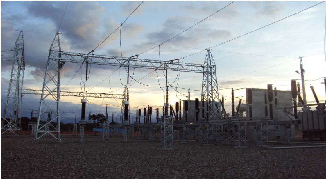
Foto: Vista General de la subestación Eléctrica Entre Ríos
